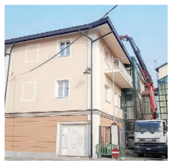
VOLVERA - I lavori di installazione dei pannelli fotovoltaici sul tetto del municipio di via Ponsati.
